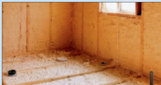
Inspekterbar ThermoCell lösull i vägg samt mellanbjälklag.
